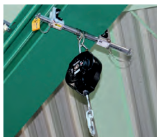
Abb. 2: Temporäre Anschlageinrichtung mit einem Einzelanschlagpunkt an der Krankonstruktion
